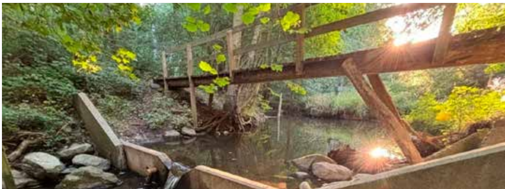
Denne betonspærring skal fjernes, så fisk og andre smådyr kan passere frit i Bagge Å
