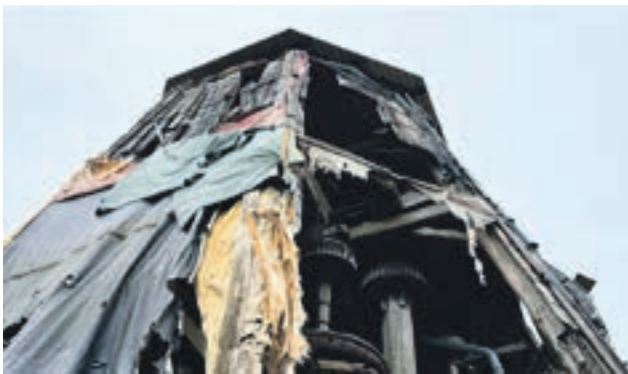
Møllen har set bedre dage. Efter mange år under presenninger er meget af træværket råddent.
